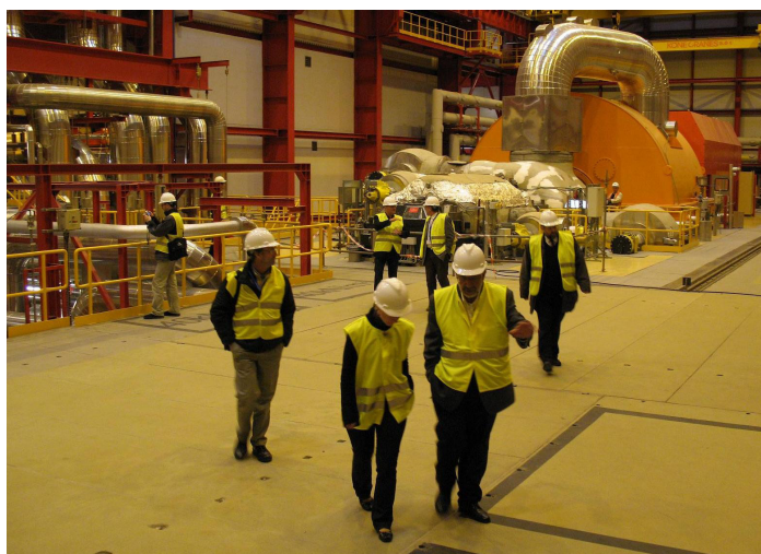
Zwiedzanie maszynowni z turbogeneratorem o mocy 460MWel
